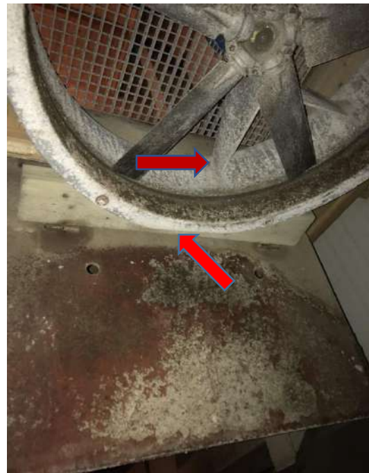
Abbildung 3 - Ventilator und Luftklappe aus Holz mit sichtbaren CIPC-Rückständen
